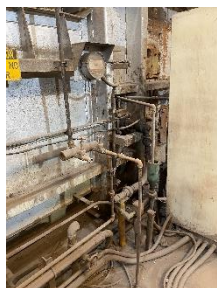
Fig. 13: Cuadro de refrigeración
