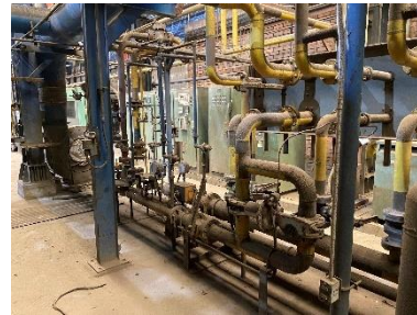
Fig. 20: Cuadro principal de gases
