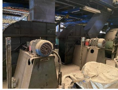
Fig. 31: Ventiladores de enfriadores
