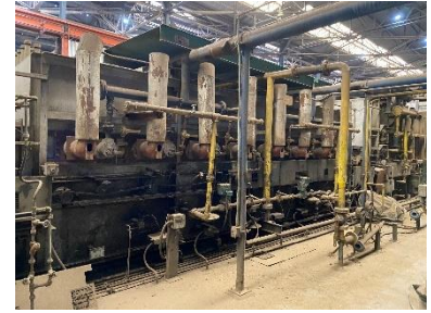
Fig. 18: Salida de gases (Zona de Tubos)
