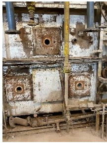
Fig. 16: Calzos de quemadores
