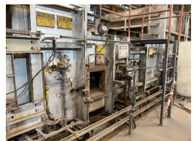
Fig. 12: Zona de precalentamiento Horno
