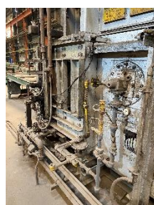
Fig. 14: Cuadro de gas a quemadores
